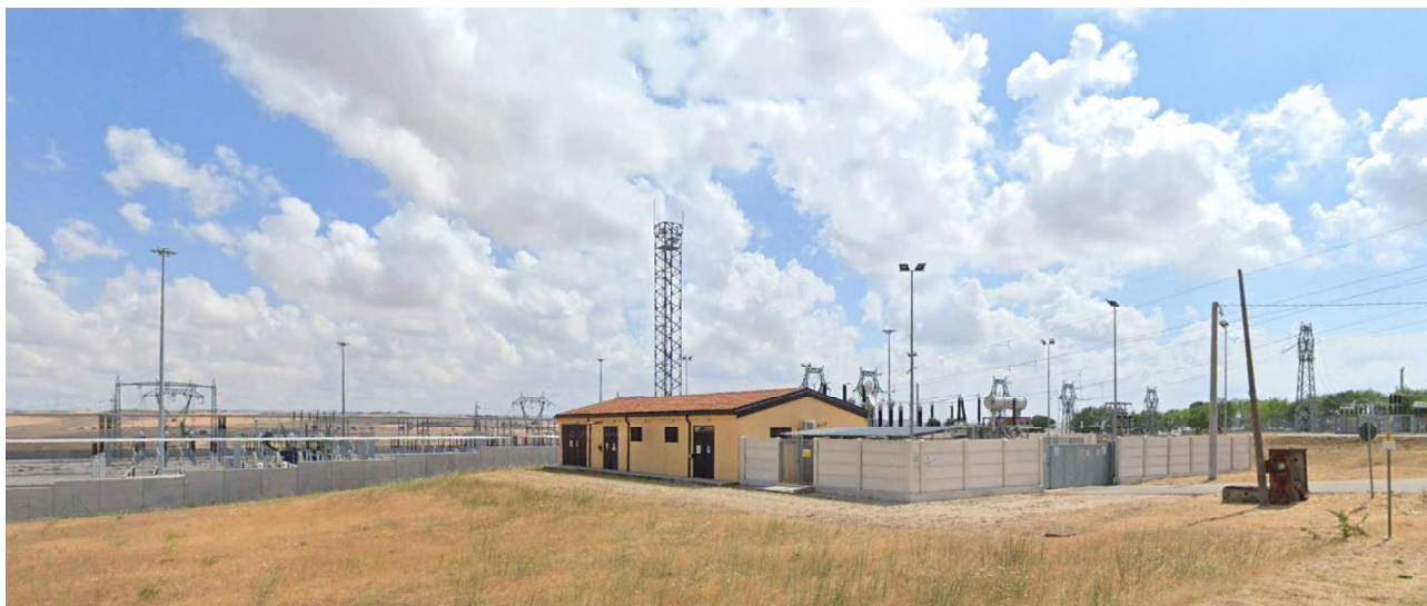
Foto dell'area dello stallo e della stazione elettrica TERNA
