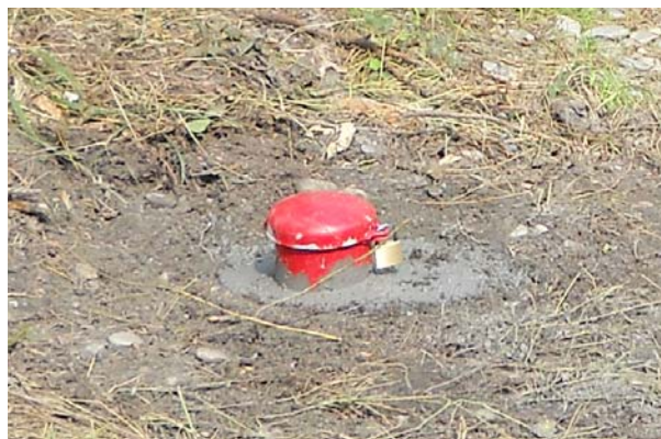
Pozzetto su SC6pz
