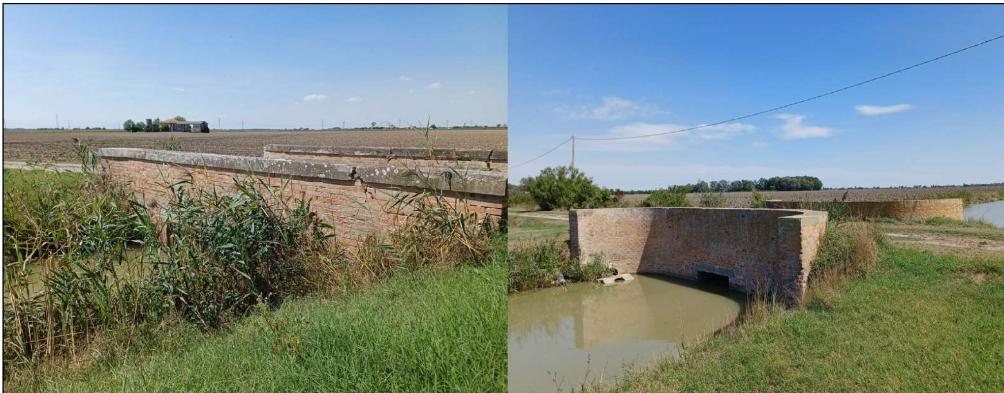
Ponte non idoneo lato nord
