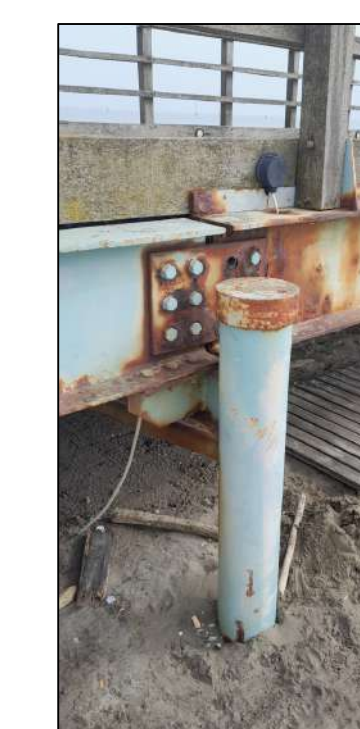
5) Dettaglio degrado struttura
