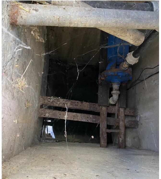
Figura 23 – Sorg 01 impianto di pompaggio interno all'opera di presa.
