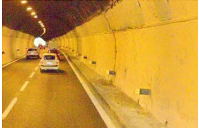
Figura 4-6 – Centinatura e aloni di umidità in corrispondenza dei piedritti della canna Nord a circa 60 m dall'imbocco lato Roma.
