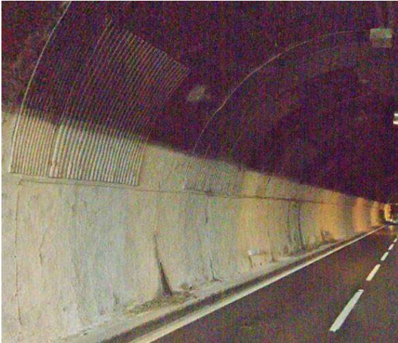
Figura 4-5 – Centinatura e aloni di umidità in corrispondenza dei piedritti della canna Nord a circa 280 m dall'imbocco lato Roma.
