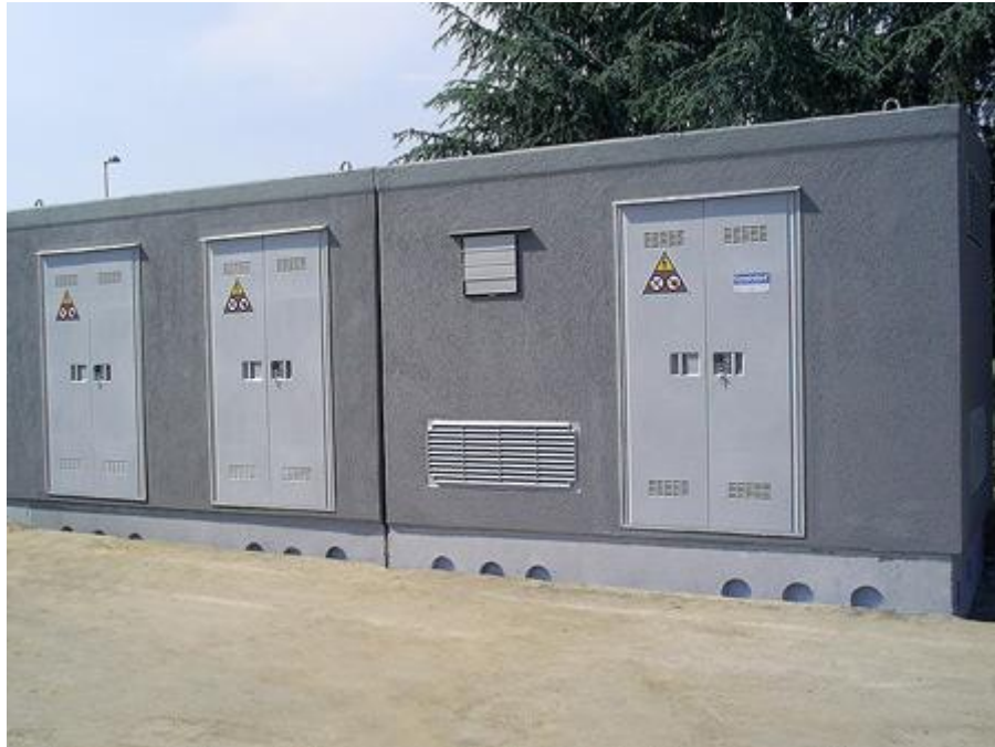
Figura 3.10: Esempio di cabina di parallelo e control room
