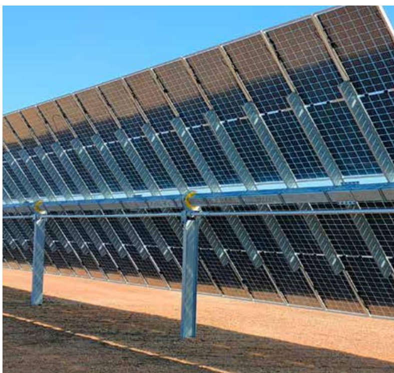
Figura 3.6: Particolare inseguitori monoassiali
