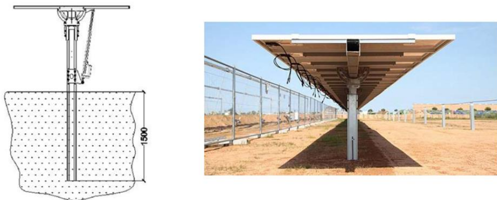
Figura 4.16: Sezione della profondità di infissione dei pali di sostegno e particolare dei moduli pronti al cablaggio
