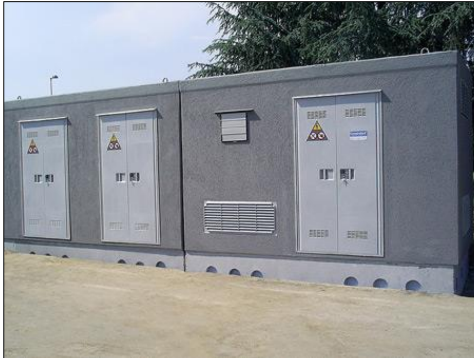
Figura 4.13: Esempio di cabina di parallelo e control room
