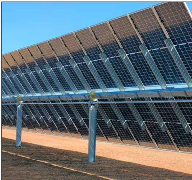
Figura 4.9: Particolare inseguitori monoassiali
