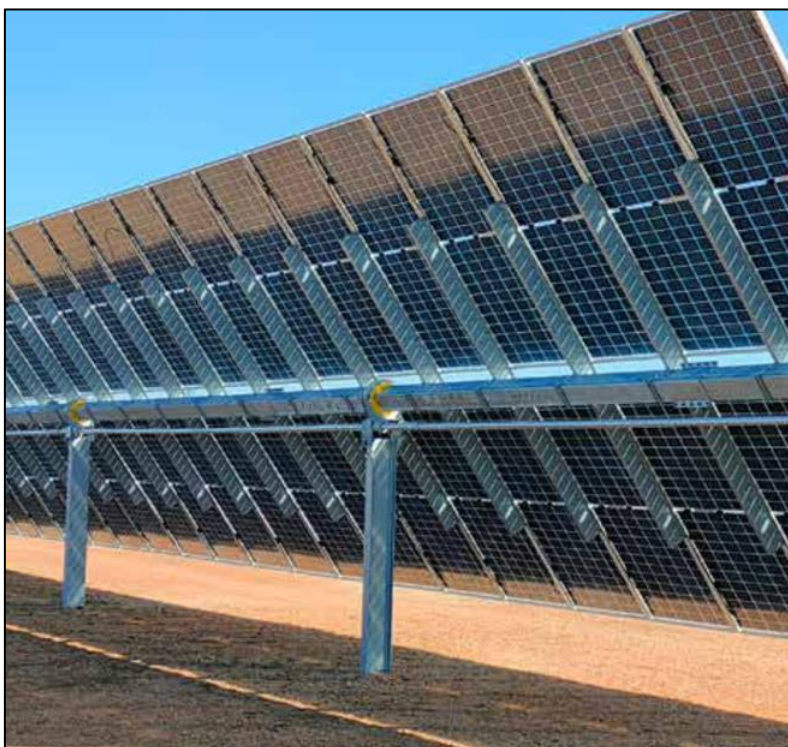
Figura 4.9: Particolare inseguitori monoassiali
