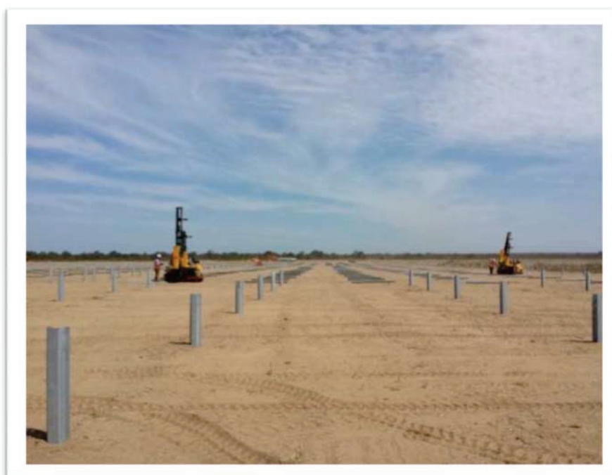
Figura 12 – Foto esempio di Impianti realizzati con stessa struttura e stessi moduli fotovoltaici.
