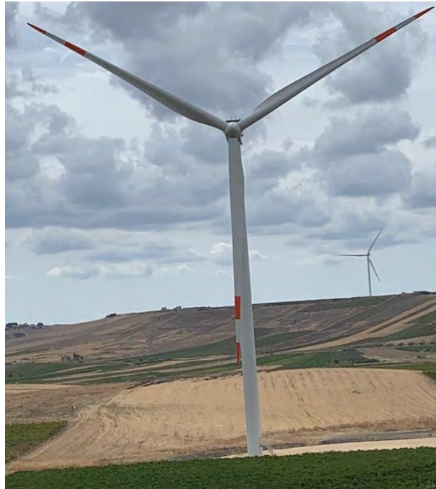
Figura 7-6: Esempio di aerogeneratore con pale a bande rosse
