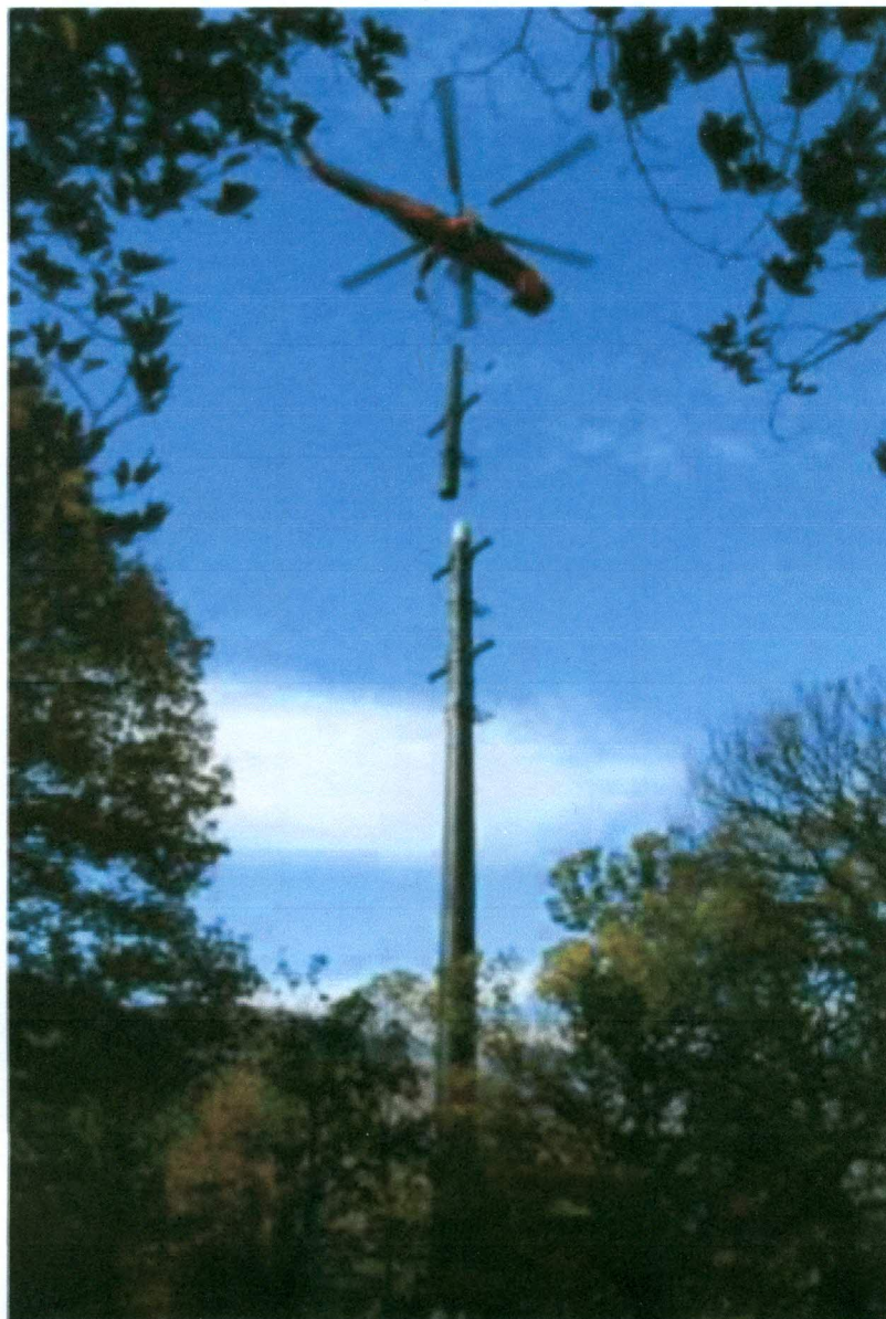
Parco dello Stelvio 380 kV (2005)
