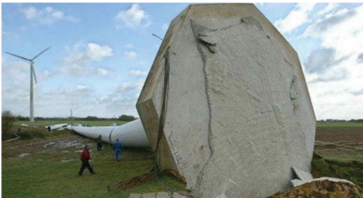
Figura 8- Ribaltamento della torre e del plinto
