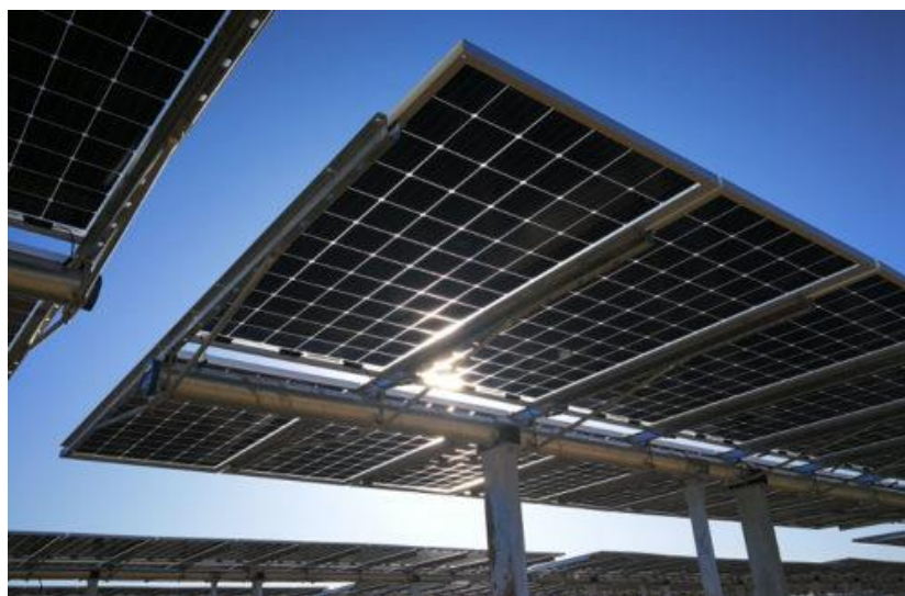
Figura 3.2: Esempio di struttura a tracker monoassiale.
