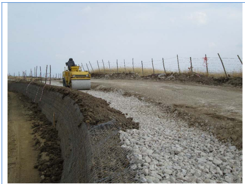
Figura 8.2 – Esempio di opera in terre rinforzate - Fonte HE
