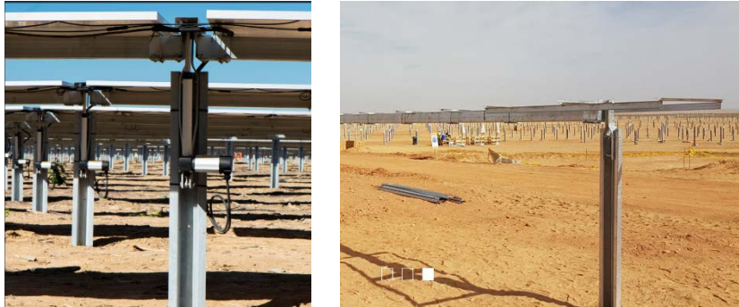
Figura 6 - Particolare strutture ad inseguimento ed attuatore
