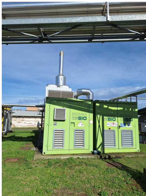
Figura 6.5 – Container cogeneratore esistente e camino E11
