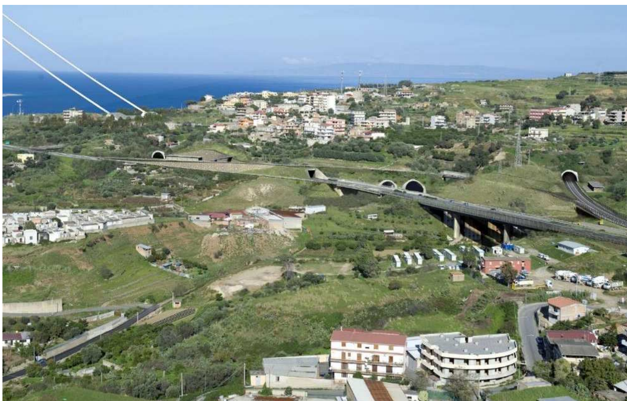
Figura 1.12 - Fotoinserimento Versante Calabria (viste imbocchi galleria naturale Piaie e rampe "D", "L" ed "M")
