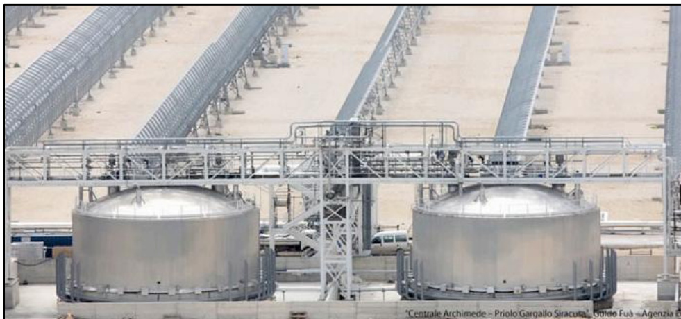
Figura 71: Serbatoi di Accumulo - Esempio
