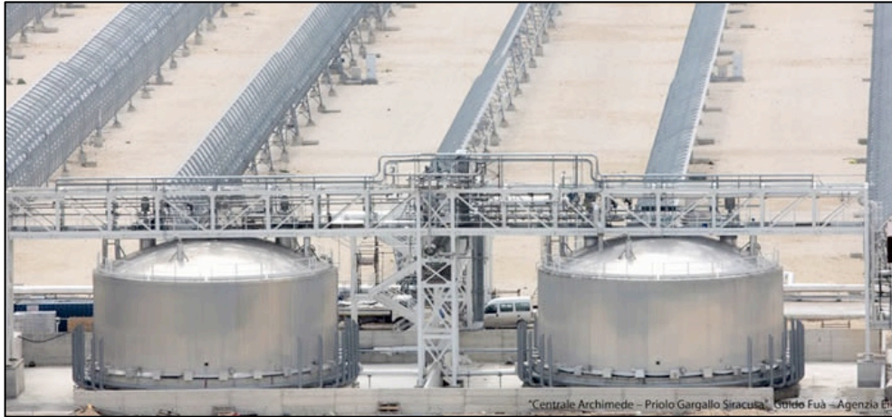
Figura 22: Serbatoi di Accumulo - Esempio
