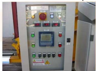
Figure 6.28 Quadro di controllo
