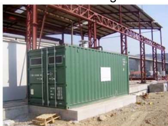
Figure 6.26 Generatore di vapore
