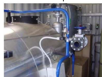
Figure 6.27 Generatore di vapore
