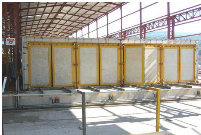
Figure 6.22 Impianto di maturazione a vapore - esterno
