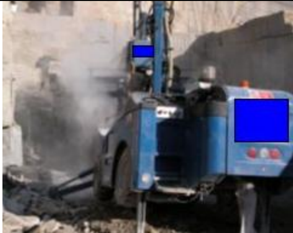
dispersione polveri a bocca foro da una perforatrice idraulica a spurgo detrito pneumatico in assenza di sistema di captazione polveri
