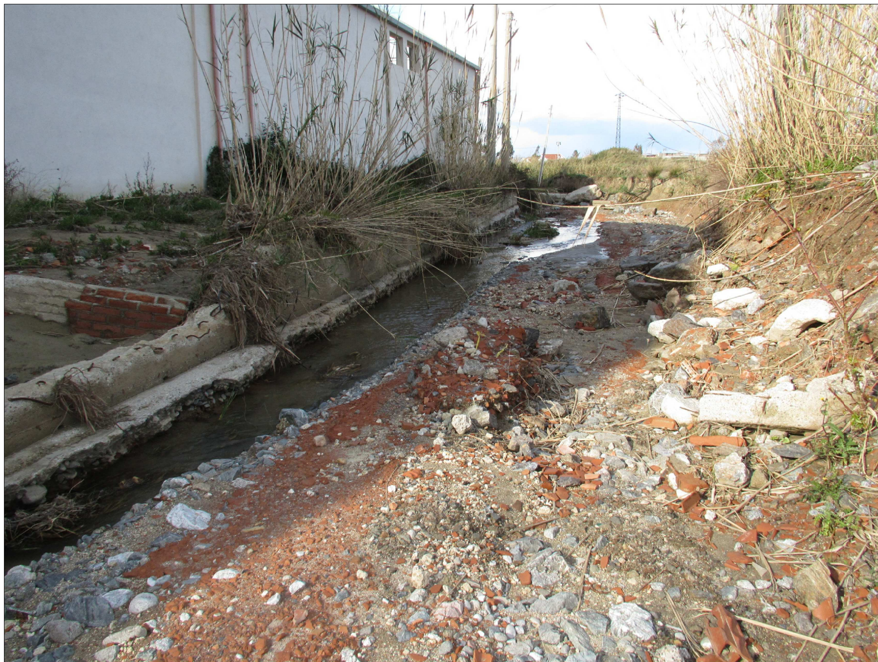
Fig. 2b – Alveo del T. Senia dissestato in prossimità di un capannone
