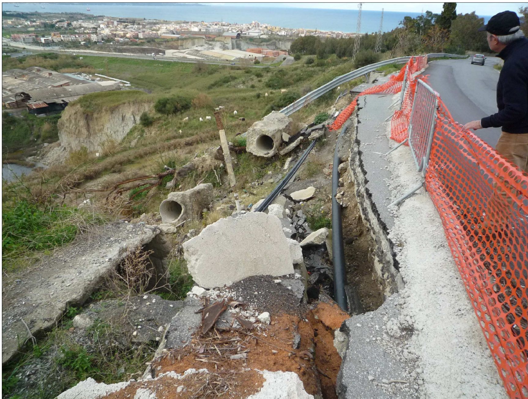
Fig. 1d – Dissesto a margine della Strada Panoramica Tracoccia
