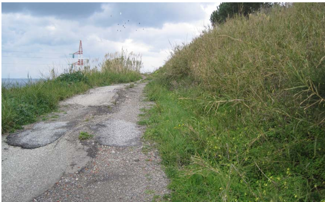
Strada privata da ammodernare (tratto 5-6)
