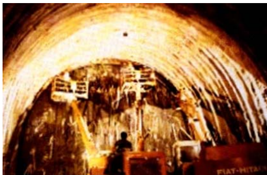
Immagine 7: Uso di cestelli portapersona per l'installazione delle centine
