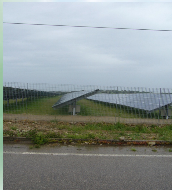
Impianto fotovoltaico in area industriale
